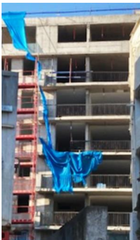
Fig. 1: Ejemplo aspecto ritmo de construcción, ausencia de protección de borde
