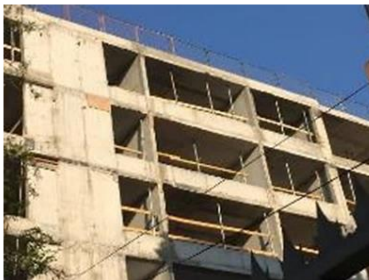
Fig. 3: Ejemplo de ausencia de resistencia estructural
