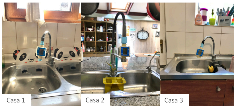
Figura 52 - Instalación de medidores en distintas casas Fuente: Elaboración Propia
