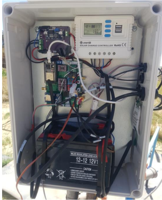
Imagen 7. Fotografía de la caja estanca con la electrónica del sistema de monitoreo y el sistema energético, incluido el regulador de carga y la batería.
