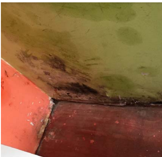
Imagen 26: Fotografía CS. Reconstruyendo Placilla, humedad en dormitorio principal. Fuente: Elaboración propia.
