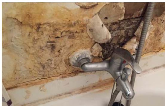
Imagen 25: Fotografía CS. Reconstruyendo Placilla, humedad en baño. Fuente: Elaboración propia.
