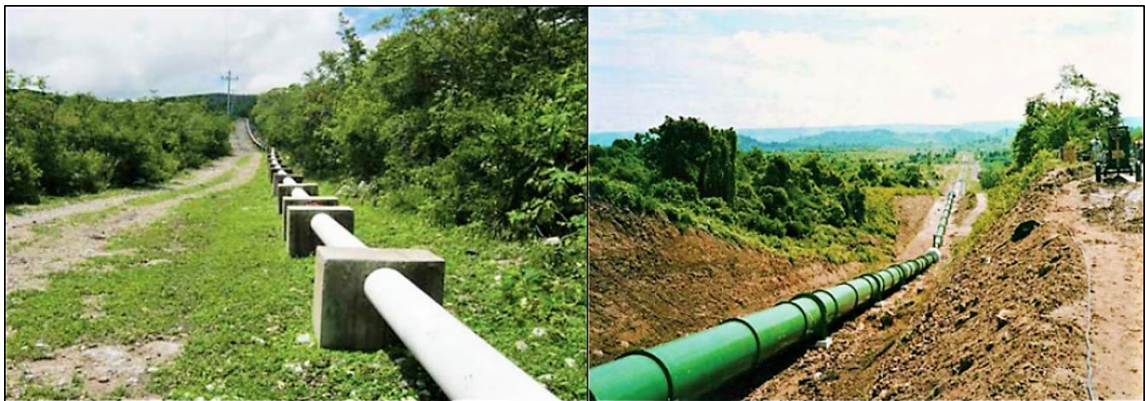
Figura 10: Tuberías en línea de conducción por gravedad. (Fuente: USAID 2016, p.26)
