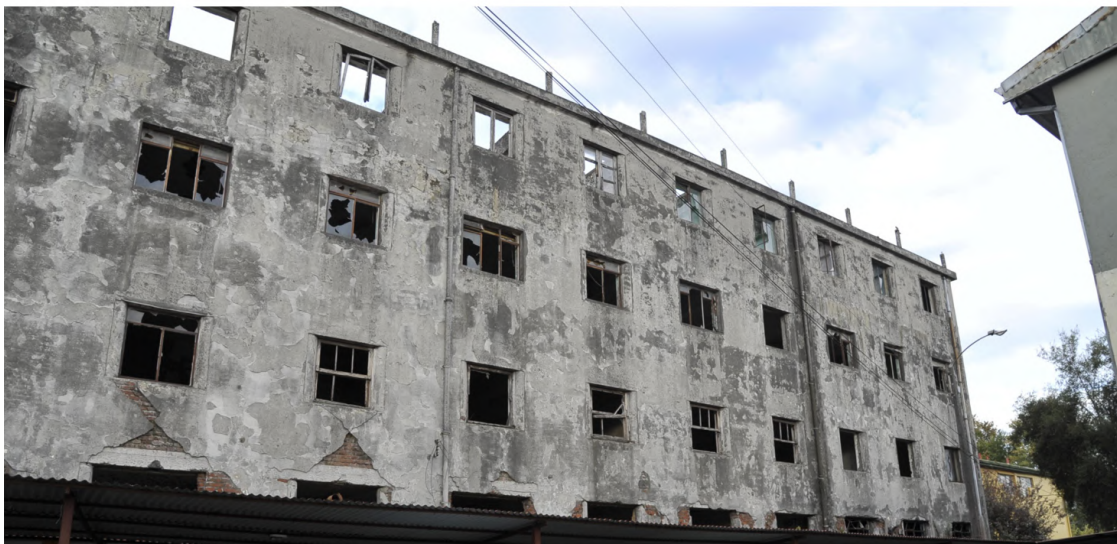
Figura 3.4: ( Desde arriba hacia abajo, de izquierda a derecha ) Restaurant abandonado, Cocholgue; ex fabrica de gomas, Linares; edificio uso mixto, Valparaiso @ Bio bio chile ; casa de la cultura, Los Angeles. Estas y muchas otras edificaciones son observadas en la etapa de investigación, ya que forman parte del patrimonio arquitectónico y cultural; y tienen características estructurales que habilitan su re-utilización (de los edificios)
