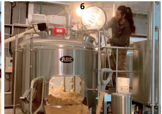
El macerador tiene dos aperturas. Desde la superior manguera para que caiga al bin todo el bagazo.
