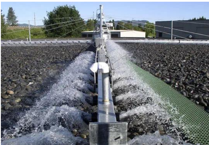
Figura 8 Sistema de tuberías, Distribuidor automático, HydroDoc
