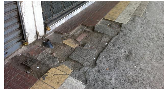
Imagen 3_Veredas en mal estado Concepción
