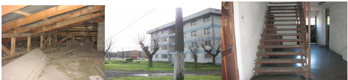
Ilustración 57: Fotografías cubierta sin aislación y alero, interior caja escala. fuente: elaboración propia.
